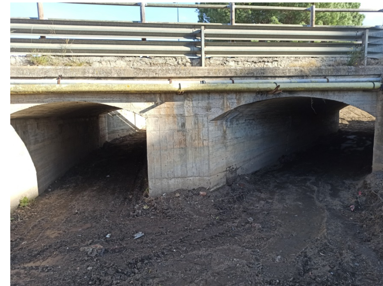
Imatge 5. Vista sortida obres hidràuliques
