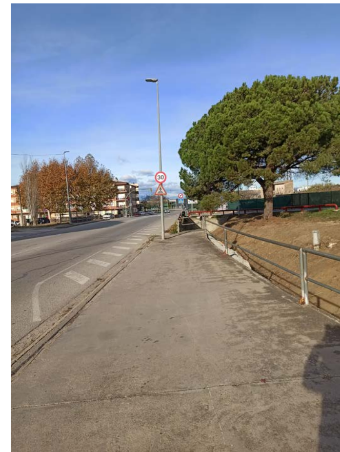
Imatge 8. Vista marge esquerre plataforma de formigó amb enllumenat afectat
